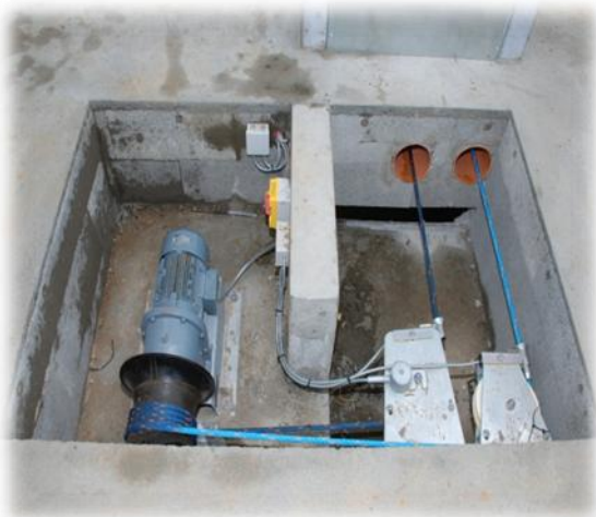
Figur 3. Trækstation til kanalskraber
